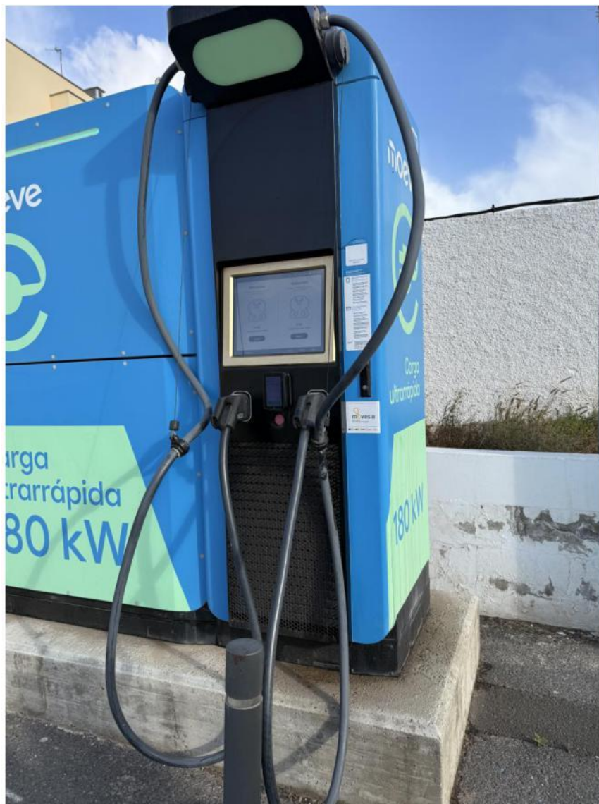
Frontal Cargador XCHARGE 180 kW de la ES LAS REMUDAS
